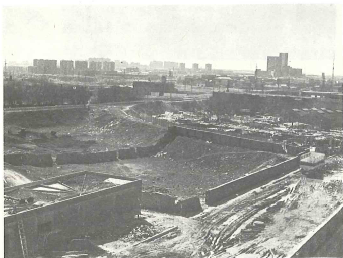
Deficiencias del material empleado, de los saneamientos y reducidísimos espacios para moverse.
